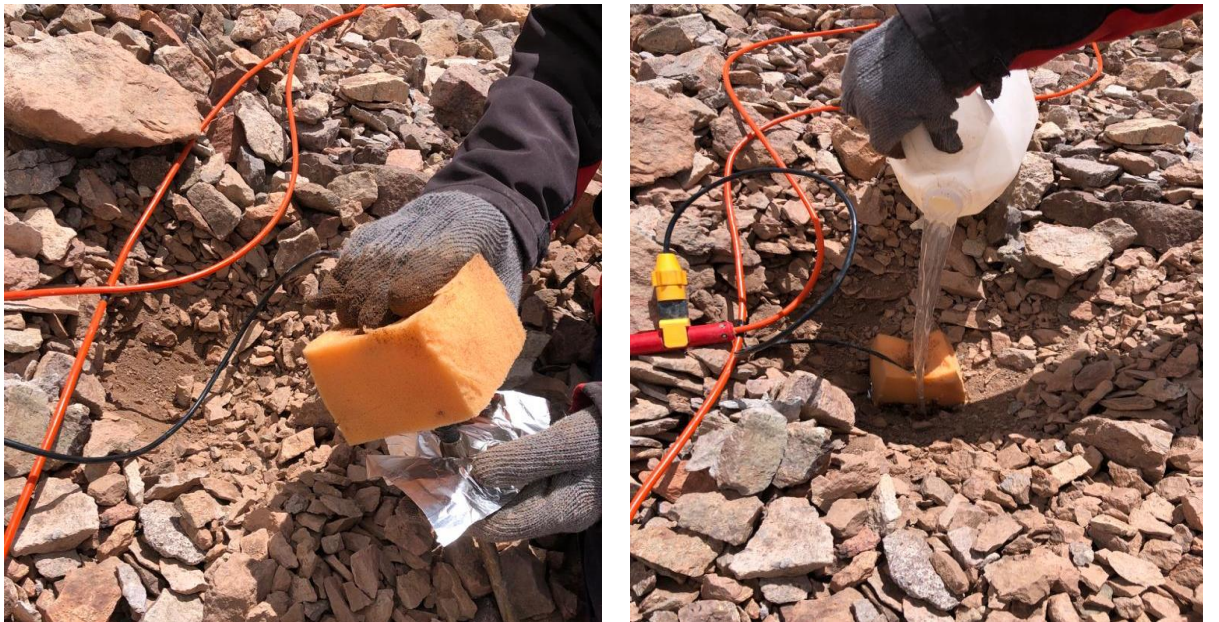
Figura 17. Colocación de esponjas, láminas de aluminio y solución de agua con sal para disminuir la resistencia de contacto.
