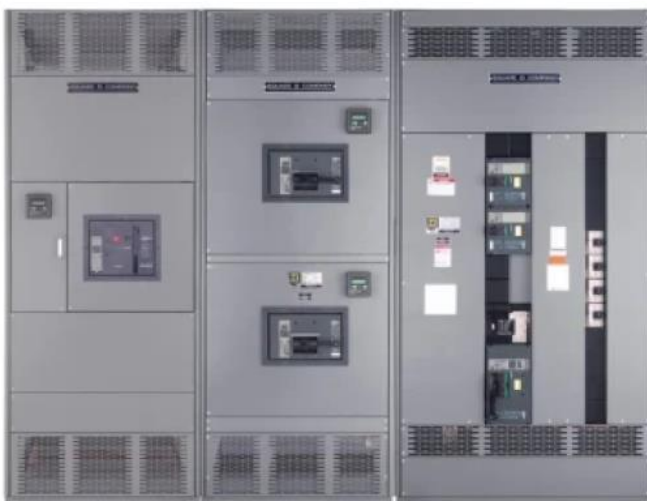
Ubicada en Sala de Maquinas General.
