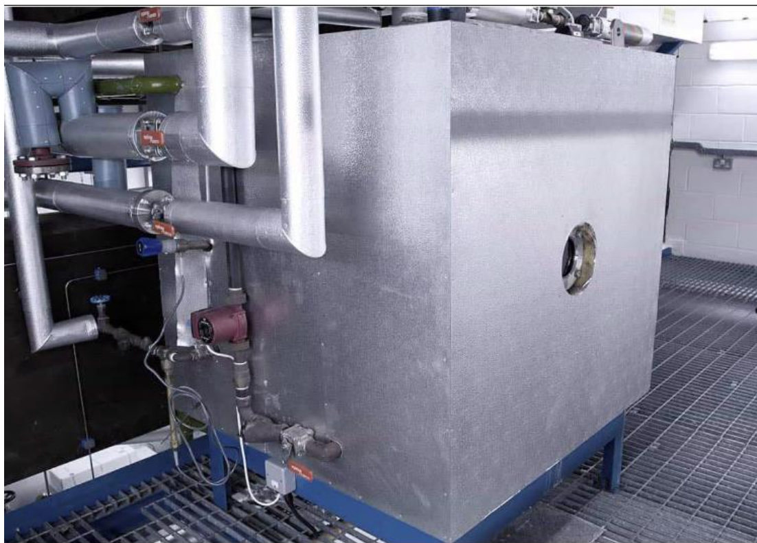
Figura 8.4 Tanque de condensados TM-6 de 6000 litros de capacidad.
