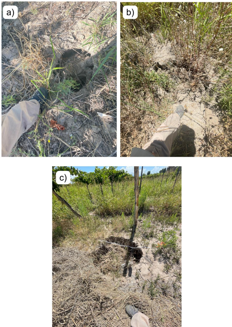
Figura 82: Ejemplos de socavones observados en la finca ubicada sobre calle 3 (departamento 25 de Mayo). a) Hundimiento circular (S1) de pequeño tamaño (<1 m de diámetro) con bordes bien definidos, ubicado en el margen de un parral y asociado a procesos de colapso del suelo. b) Segundo socavón (S2) de morfología similar, de aproximadamente 1 m x 1 m, donde se evidencia la inestabilidad superficial y la infiltración preferencial del agua de riego. c) Socavón de mayor desarrollo (S3), con dimensiones cercanas a 1,30 m x 2 m, emplazado junto a la estructura de sostén del cultivo; presenta paredes verticales y un vacío interno que indica un proceso avanzado de subsidencia vinculado a paleocauces enterrados.
