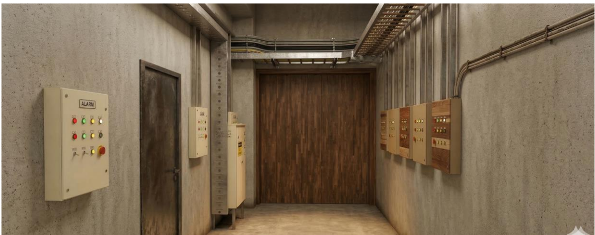
SALA DE TABLEROS ELECTRICOS
