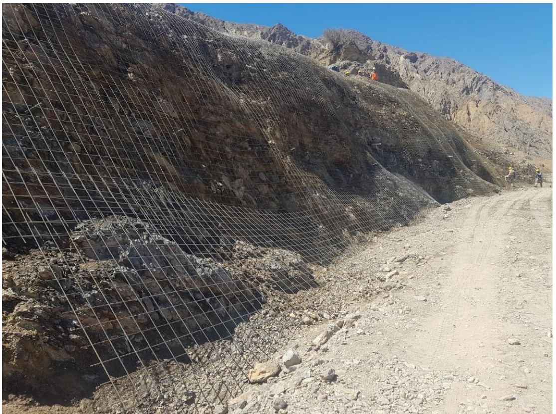
Figura 109. Mallas electrosoldadas instaladas en el talud, previo a la colocación del hormigón proyectado.
