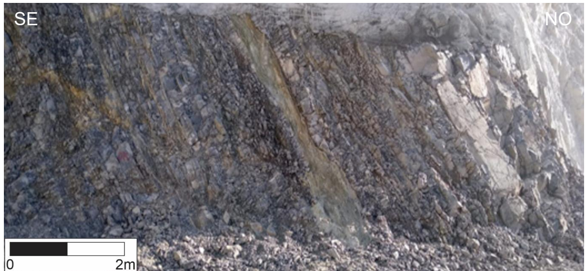
Figura 3.46: En la imagen se observa la zona del remate del talud, donde se observa la intercalación planar de arcillas bentoníticas.
