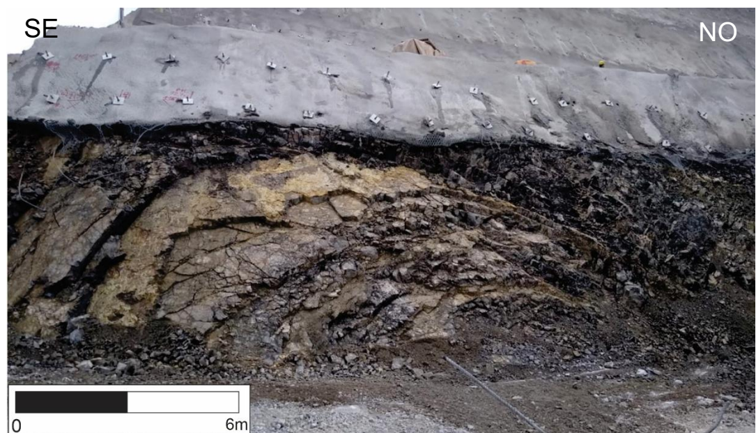
Figura 4.14: En la imagen se observa la estructura de plegamiento anticlinal volcado y la roca fragmentada y teñidas por los óxidos.
