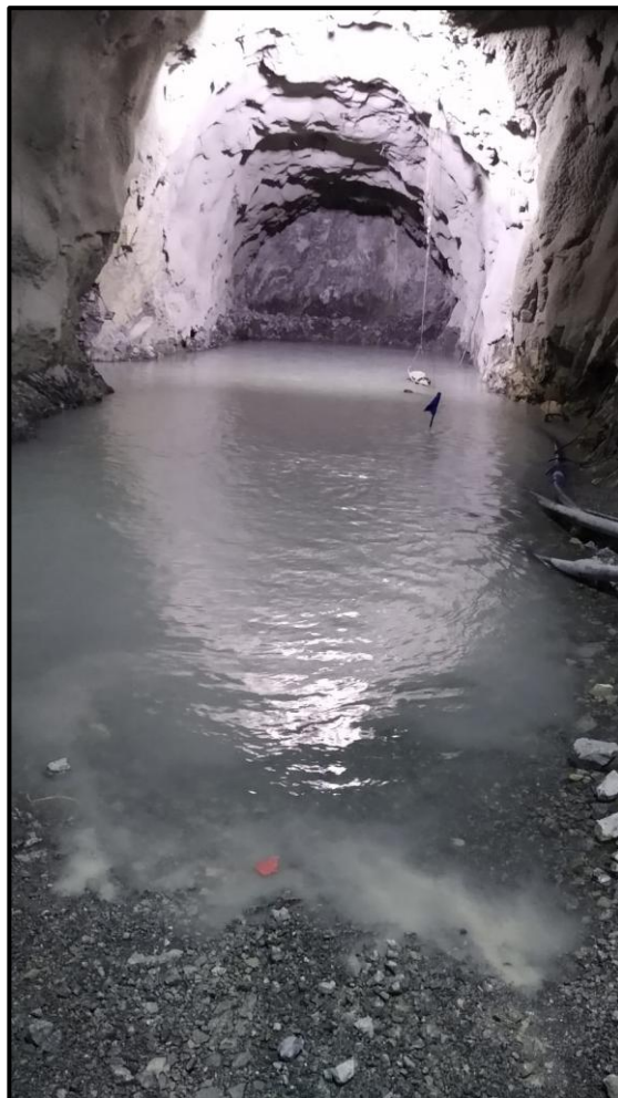
Figura 1.8: Imagen de la excavación de la galería de acceso de bifurcador, donde se observa la filtración de aguas subterráneas en la zona del piso, la altura media del túnel es de 5.78 metros.
