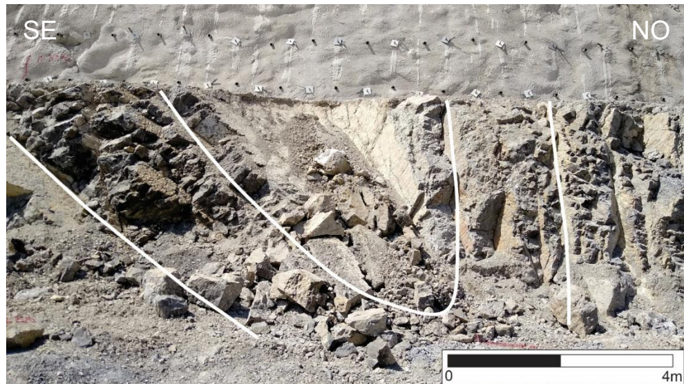
Figura 3.32: Se indica con líneas blancas la posición del pliegue con respecto a la excavación del talud.
