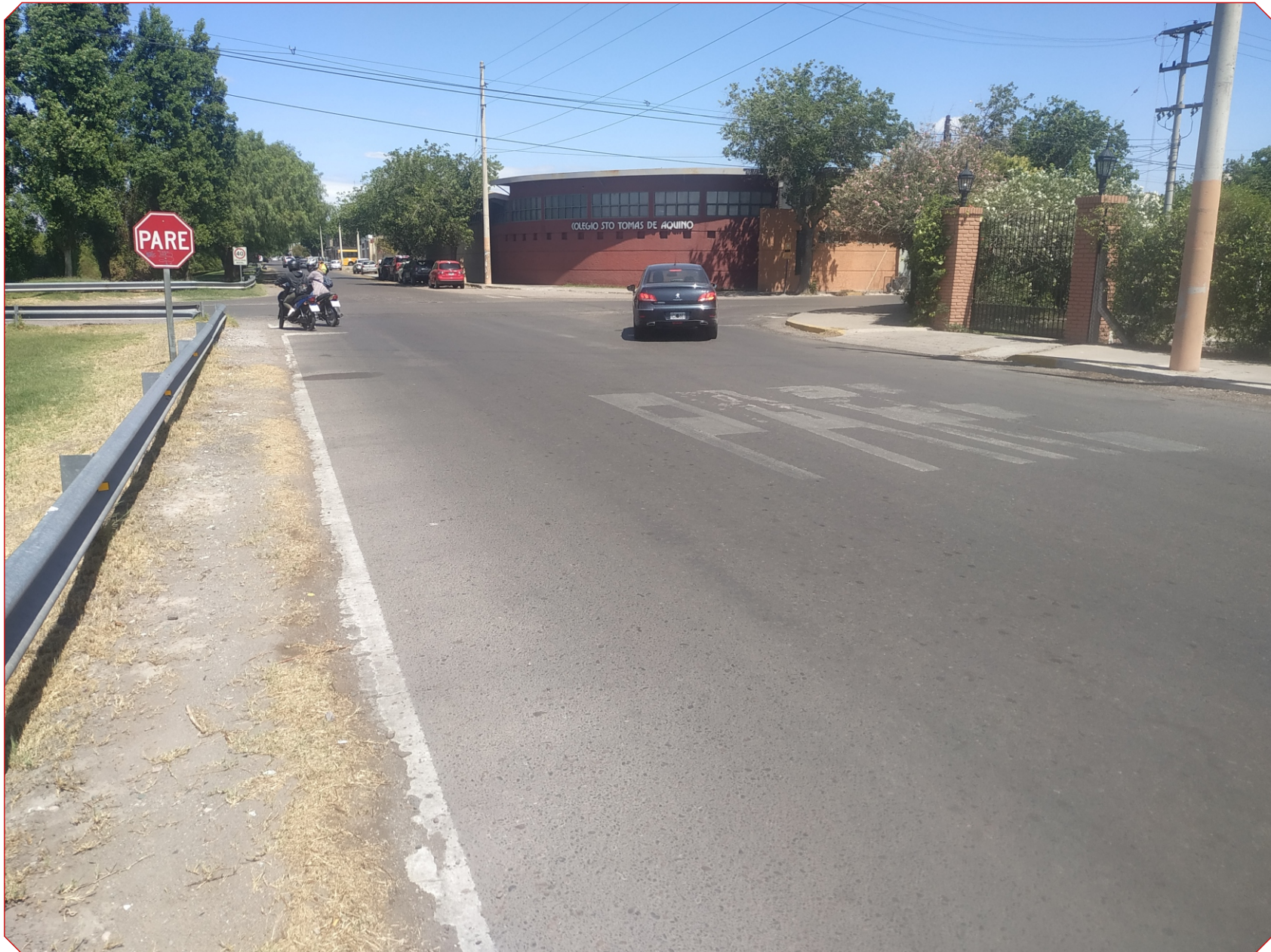
Exploración de Campo, en las calles sanjuaninas. señales gastadas, muy bajas o inexistentes.
