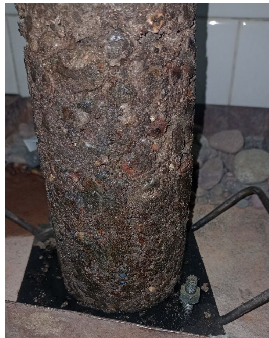
Transpiración y vestigios de humedad.
